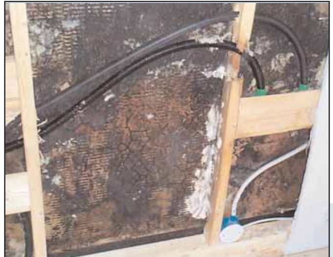
Bildet viser et 5 år gammelt bad. Dette er skader som er skjult og vanskelig å oppdage de første årene. En indikasjon var at flis på vegg ikke var skilt fra gulvflisa med en myk fuge. Fra tilstøtende rom var det ikke noe problem å konstatere høy fuktighet og massiv vekst av muggsopp.
